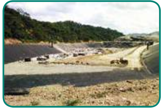
Relleno sanitario La Bonanza , estado Miranda. Fuente: Archivo del MPPE (2012) MINCI.
